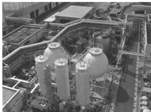
図12 バイオマス受入設備（東灘処理場）
