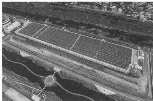
図6 太陽光発電設備（垂水処理場）
