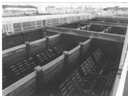
図14 フロキュレータ設備
