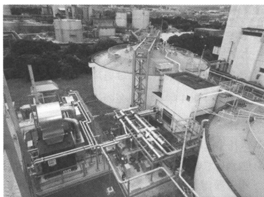
写真－2 西部浄化センター消化ガス発電設備
