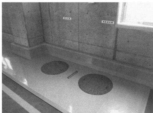
受水槽と希釈混合槽
