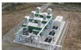
宍道湖東部消化ガス発電所 (松江市竹矢町)
