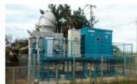
湯梨浜地熱発電所 (東伯郡湯梨浜町)
