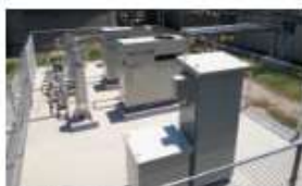
内浜処理場消化ガス発電所 (米子市安倍)
