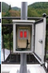
非常用コンセント
