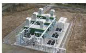
穴迫湖東部消化ガス発電所 (松江市竹矢町)
