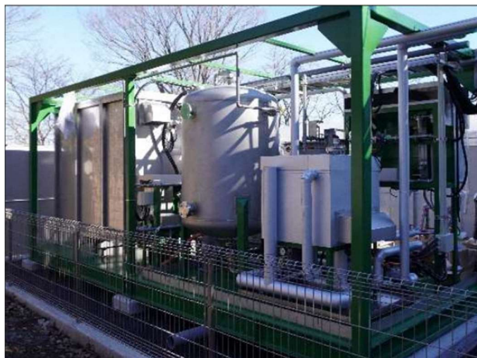
図表2 メタン発酵バイオガス発電設備
